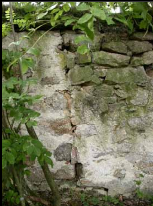
Severozápadní roh původního hřbitůvku, patrný jako svislá spára v nynější ohradní zdi.
